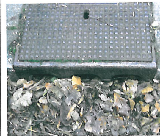
Een straat moet zo zijn ingericht dat kolken niet verstopt kunnen raken en makkelijk bereikbaar zijn om leeg te zuigen. FOTO'S WITTEVEEN+BOS
