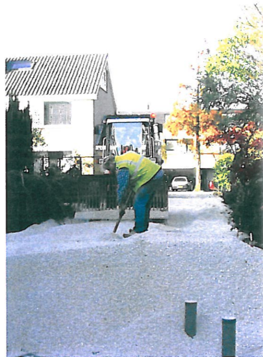
In Reeuwijk hoogt de gemeente straten op met Bims. Later, toen de prijs van Bims steeg, is overgestapt op Argex. FOTO: FERRY HEUVELMAN
