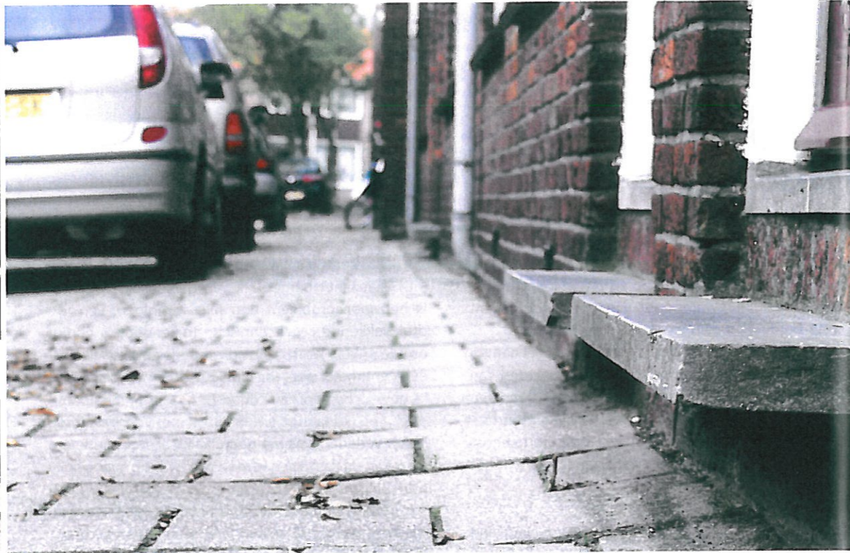
Bij woonhuizen in Gouda is soms een opstapje nodig om de restzettingen te overbruggen. FOTO SEBASTIAAN OLSMAN
